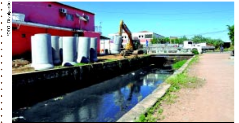
[FOTO&LEGENDA] As obras do projeto "Canal Vivo", no município de Sousa, continuam em ritmo acelerado entre os bairros Gato Preto e Centro. Orçado em mais de R$ 8 milhões, o projeto quer acabar com o esgotamento sanitário irregular no município.
